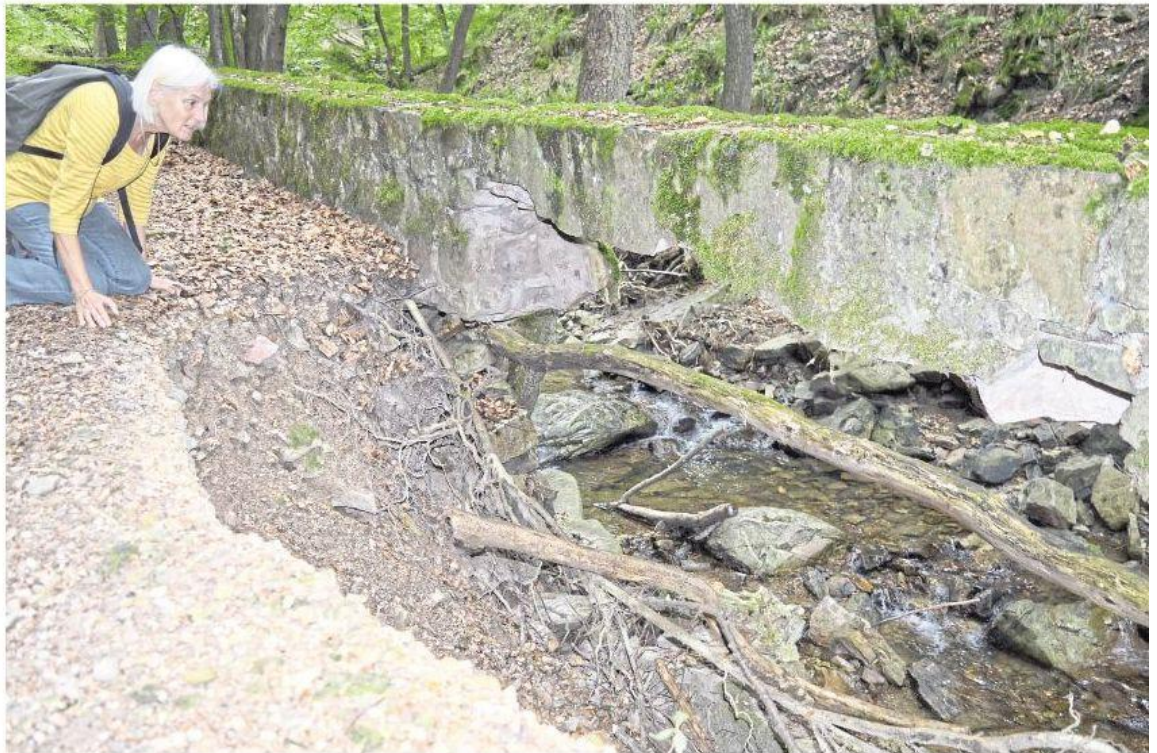
Die Unwetter von 2016 haben im Morgenbachtal ihre Spuren hinterlassen. Stützmauern wurden unterspült, auf den Wegen haben sich Krater gebildet. Um den Wanderweg wieder herzurichten, hat der Binger Stadtrat 180 000 Euro bereitgestellt. Doch bislang ist unklar, ob das Budget ausreichen wird. Foto: Josef Nürnberg
